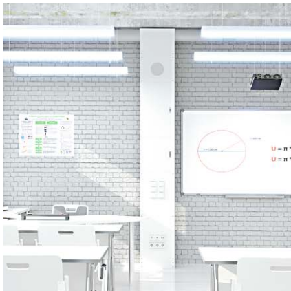
Die Mediensäule ist Herzstück und Schaltzentrale des digitalen Klassenzimmers – individuell bestückt, flexibel erweiterbar.
