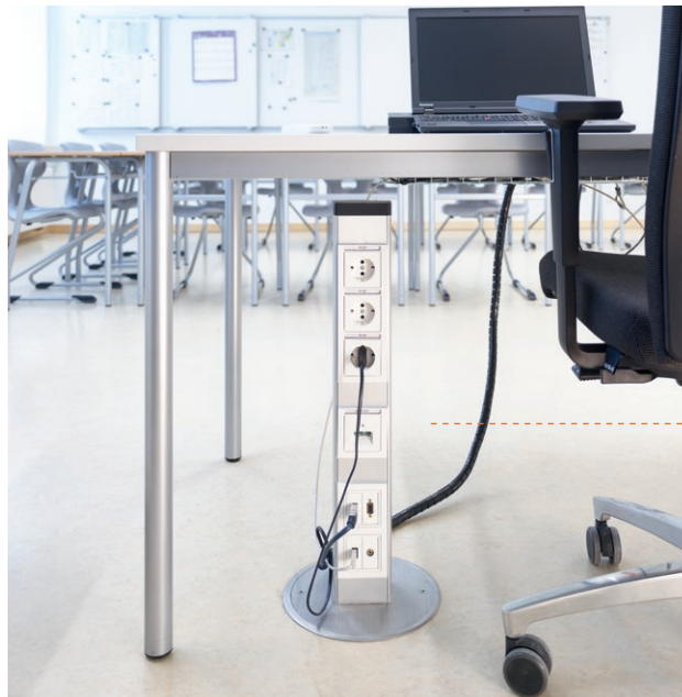
Individuell konfektionierte Standsäulen stellen Anschlüsse an jedem Arbeitsplatz zur Verfügung.
