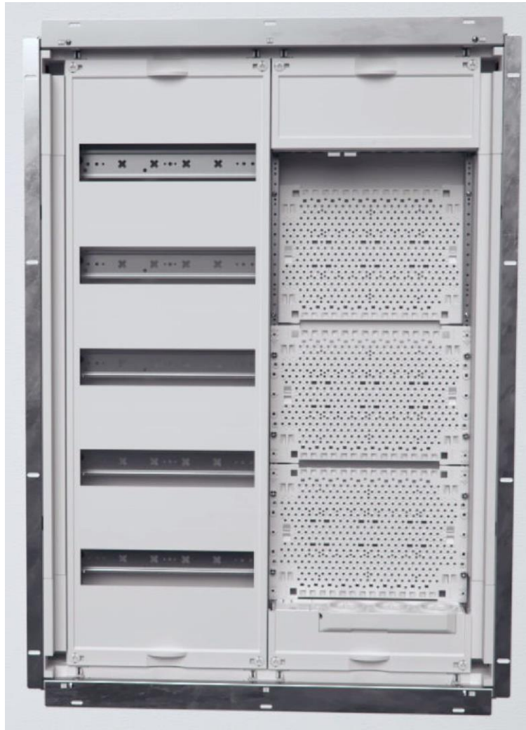
Bestückter Schrank, rechts mit montierten Multimediafeldern, Patchfeld (oben), 3-fach-Steckdose (unten) und jeweils Abdeckungen
