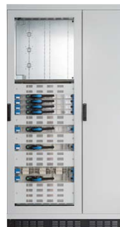
Geteilte Front, oben Klarsicht-Modultür H = 600 mm Gerätebedienung FE1 Kabelabgang rechts Hinter der Modultüre Einbau einer schwenkbaren Montageplatte, oder univers N möglich
