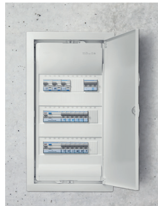
Abb. 3: FI-Schutzschalter mit sechs 1-poligen LS-Schaltern
