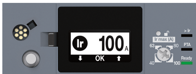
Ustawienia parametrów zabezpieczeń na panelu MCCB Energy
