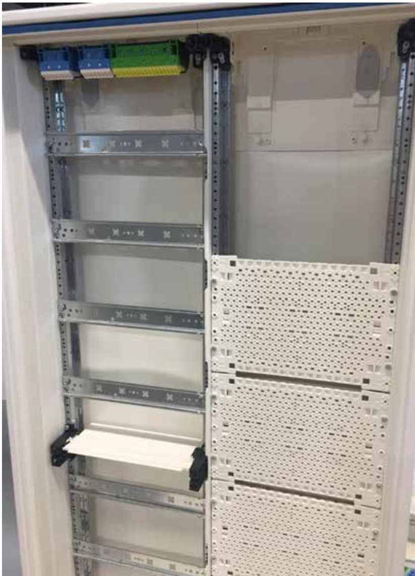
Schrank mit montierten Abschottungen
